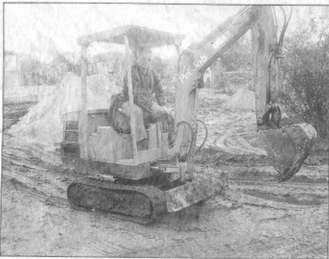
Firmenchef Harro Busse legt selbst mit Hand an, damit trotz des schlechten Wetters auch der Reitplatz noch rechtzeitig fertig wird.
